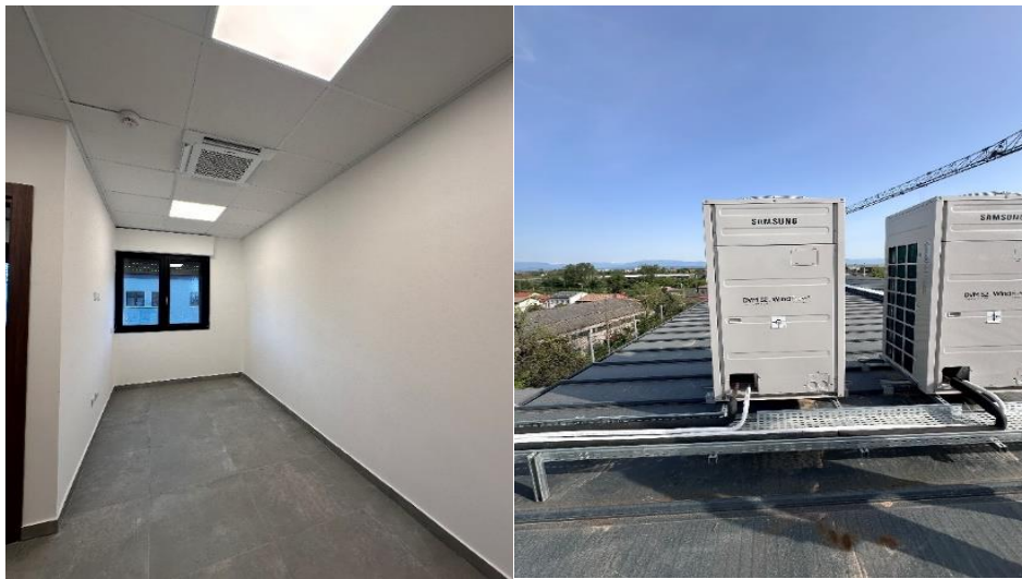
Figura 24, figura 25: Treviso, fabbricati alloggi A.M. Impianto di climatizzazione.
